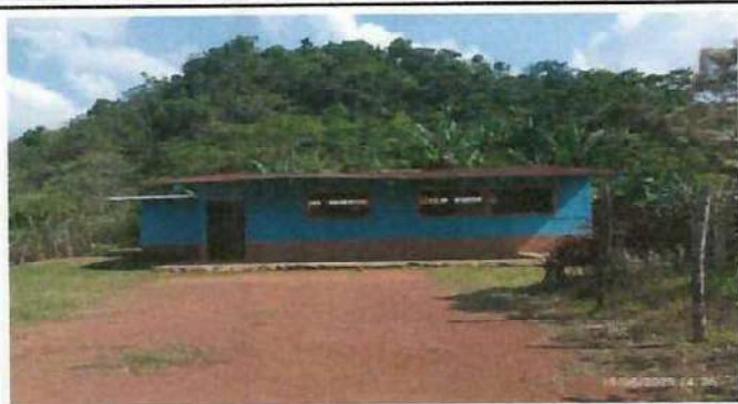
Foto1: El establecimiento esta en mal estado el techo.
