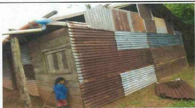
Foto 5: La cocina del establecimiento esta en mal estado.
